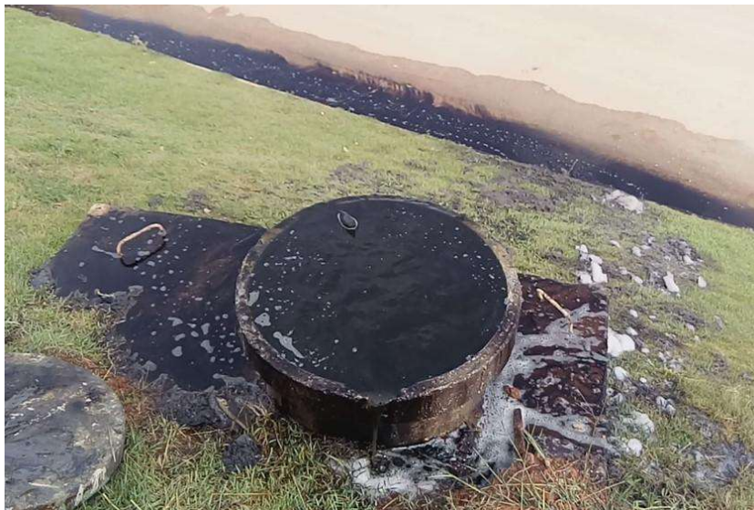
Figura 02: Um dos pontos de extravasamento do chorume no Aterro. Fonte: Metrópoles (2019).
